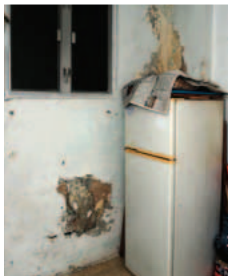
■ 樓宇狀況殘破失修。
